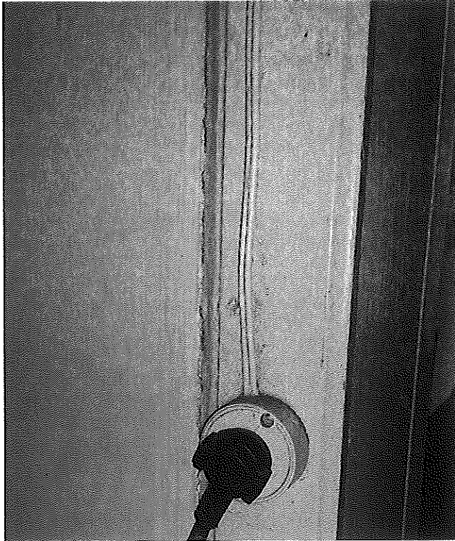
Foto 10 - Fiação exposta da sala da banda
