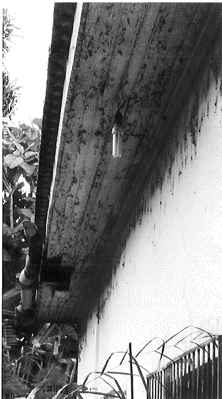
Foto 6 - Luminária Exposta ao tempo
